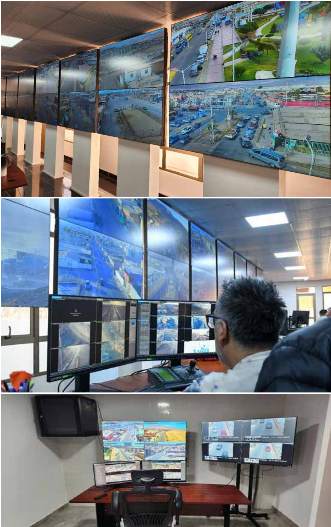
Central de Cámaras de Televigilancia
